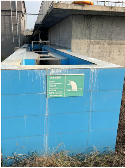
规范化废水排放口
