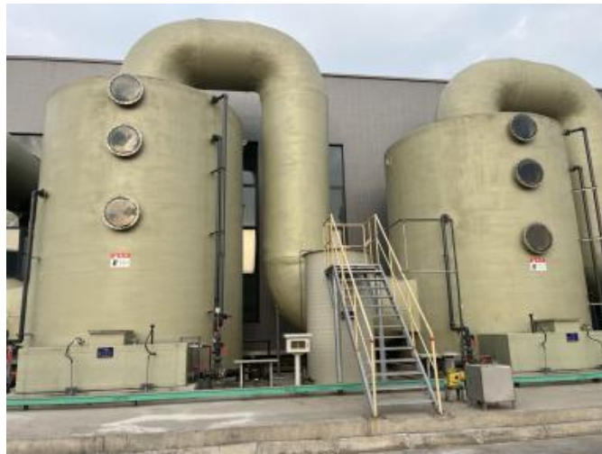
图 2.3-2 次氯酸钠氧化+碱液喷淋现场图
