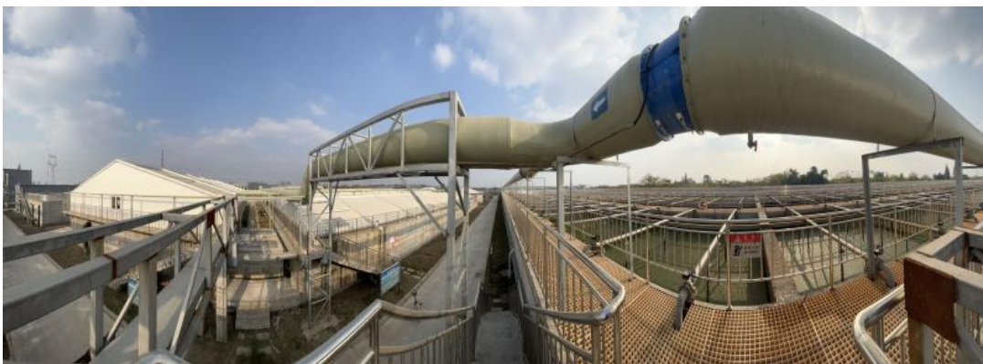
图 2.3-5 生产废水污水处理站全景图
