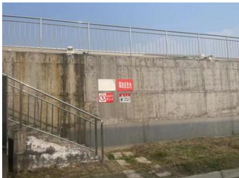
图 2.3-9 现有项目事故应急池建设情况
