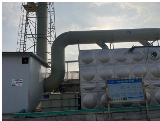
碱液喷淋+生物除臭现场图
