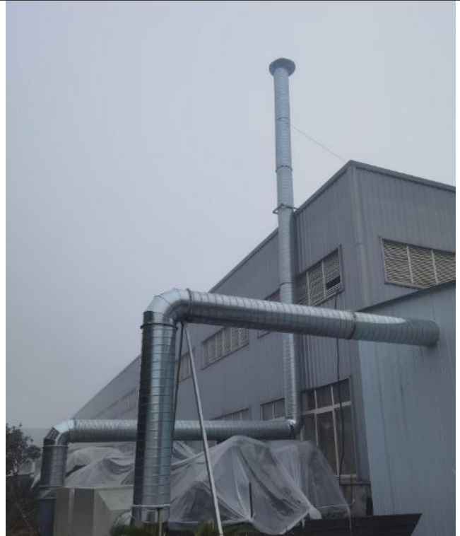
2 车间废气活性炭吸附装置+排气筒 (DA002)
