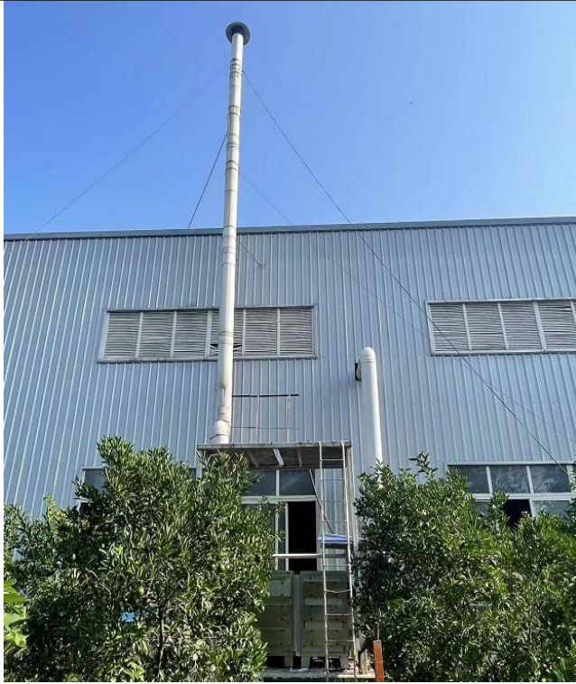
1 车间废气活性炭吸附装置+排气筒 (DA001)
