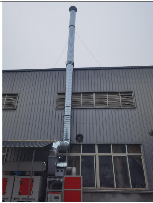
印刷车间废气催化燃烧装置+排气筒 (DA003)
