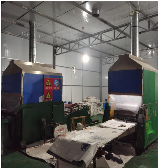
印刷车间密闭负压抽风
